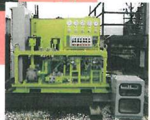
油圧系統制御盤 ▶
